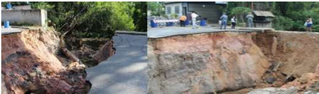
Figura 02. Área de ocorrência de deslizamento de terra, corrida de detritos e incisão fluvial na Rua São Bartolomeu - Eunápolis - Ba em dez/2021. Fonte: RASTRO101, 2023 e ATLANTICANEWS, 2023.
